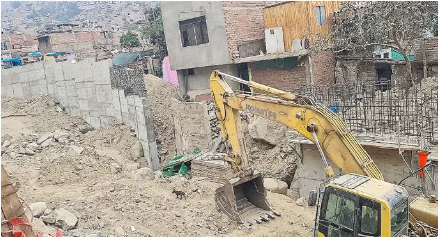
IMAGEN 3. Perú. Vivienda obstruye la construcción del muro de contención en el margen izquierdo de la Quebrada Quirio – Asociación Asentamiento Humano Nicolás de Piérola en Lurigancho-Chosica
